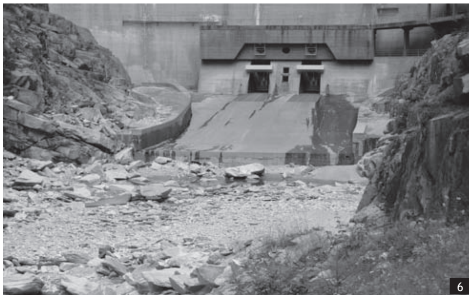
Abb.6: Das Bild zeigt, wie wenig Restwasser an der Massa im Kanton Wallis direkt unterhalb der Fassung läuft.
